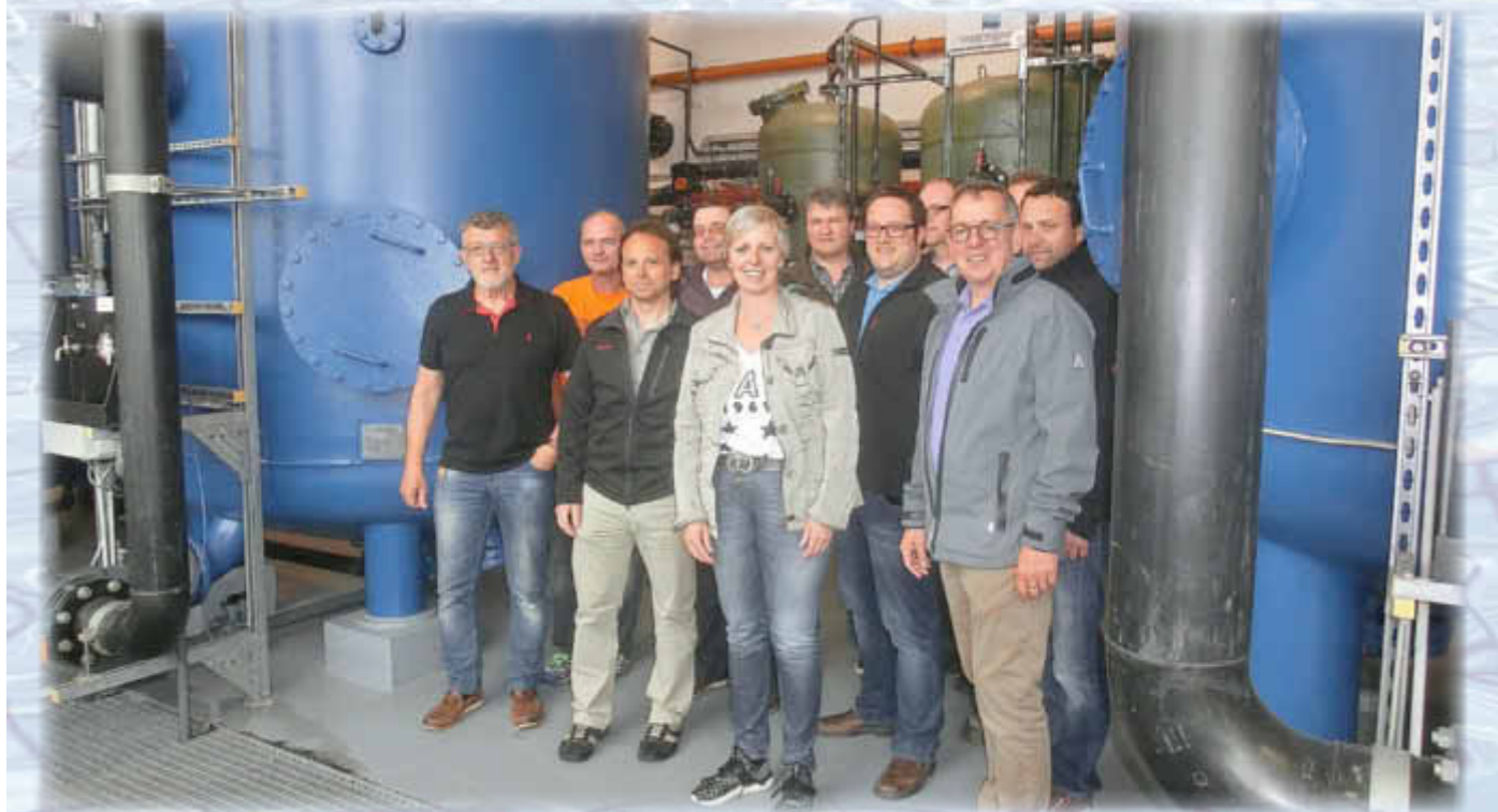
Neue AOX-Station im Panoramabad Leiwen wurde in Betrieb genommen: Diese filtert das Abwasser zusätzlich, bevor es zur Kläranlage in Leiwen abgeleitet wird. Durch die neue Anlage konnte eine Liegeterrasse beim Nichtschwimmerbecken geschaffen werden.
