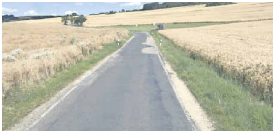
Dringend sanierungsbedürftig ist die Kreisstraße 8, die zur B 51 Hohensonne führt.
