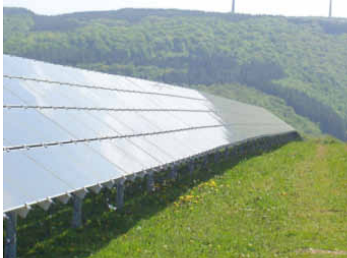
PV-Anlage auf dem Feller Berg
