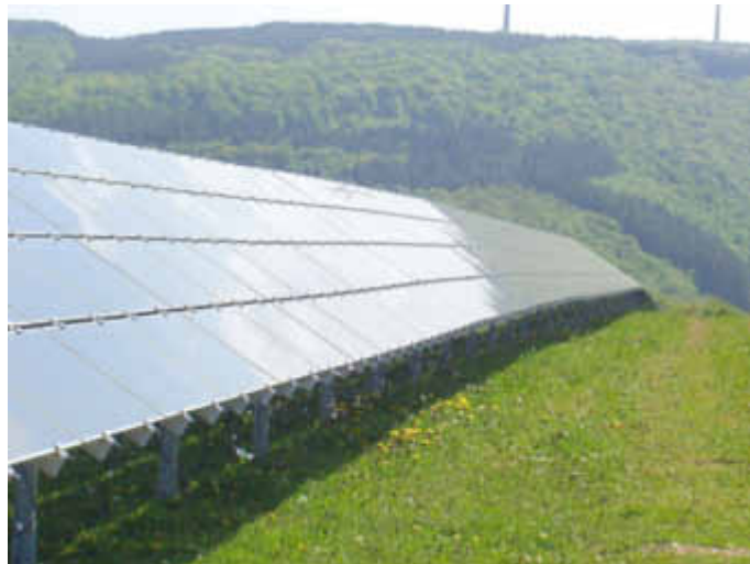
PV-Anlage auf dem Feller Berg
