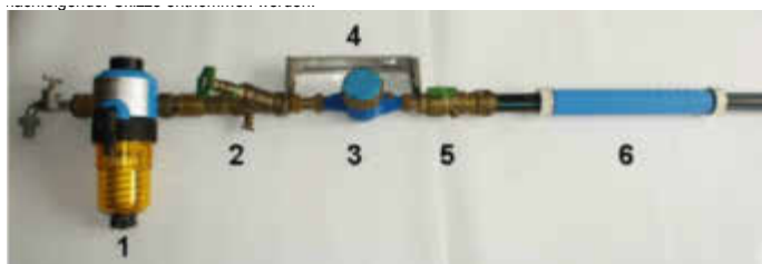
Skizze (Foto mit Beschriftung/Erläuterung) Wasserzähleranlage
