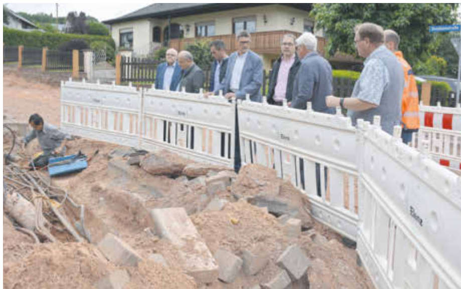
Die Baugrube für die Kommunikationsleitungen in Serrig ist ausgehoben: Landrat Günther Schartz machte sich gemeinsam mit Vertretern der Kommunalpolitik ein Bild vor Ort.
