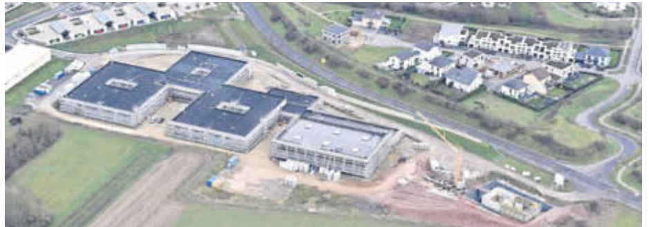
Das Luftbild zeigt den aktuellen Stand des Bauprojektes - auf der Fläche rechts unten im Bild entsteht die Eisspeicherheizung. Foto: portafly
