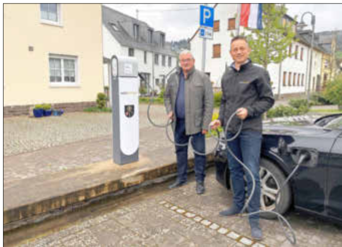
Gemeinsam nahmen Ortsbürgermeister Franz-Josef Bollig (l.) und Marco Felten (Westenergie) die neue Ladestation zum Aufladen von Elektroautos in der Ortsgemeinde Trittenheim symbolisch in Betrieb. Foto: Gina Hoffmann/Westenergie
