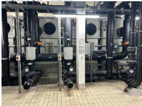
Freibad Leiwen/Schweich neue Hocheffizienzpumpen
