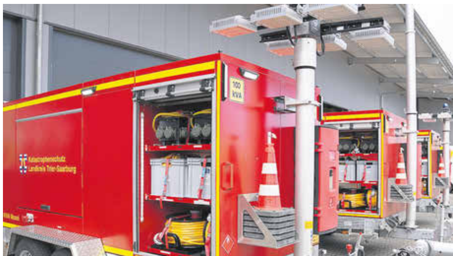
Die drei neuen Netzersatzanlagen sind auf einem Anhänger montiert, sodass sie kreisweit zum Einsatz kommen können.
